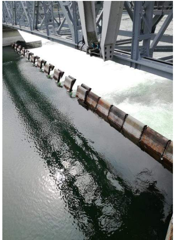
Figura 2: Degrado delle portine di regolazione
